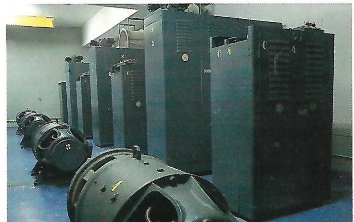
Vista parcial da Casa de Máquinas de um dos blocos do novo Centro Administrativo Itaú Conceição, um dos mais modernos conjuntos comerciais de SP, totalmente servido por elevadores Atlas
